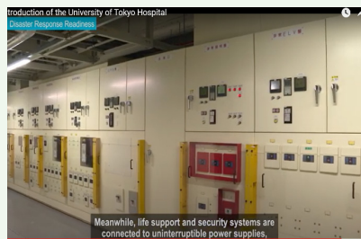
維生系統和安全系統，直接連接不斷電系統
